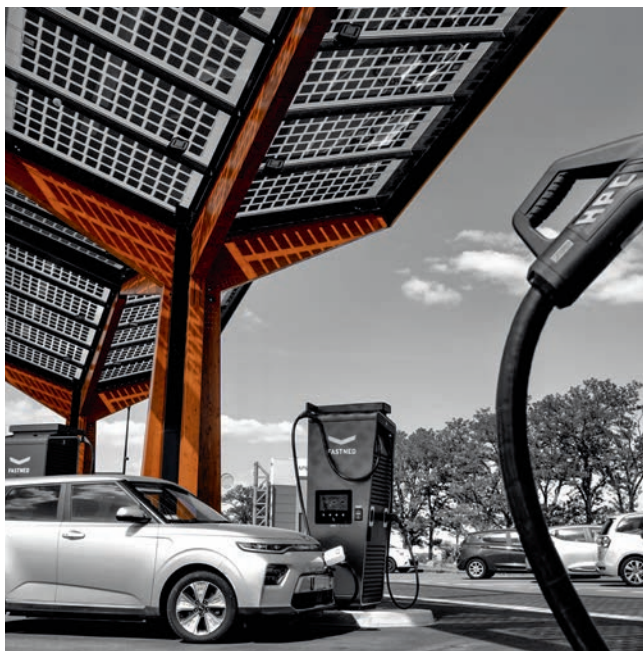
Bornes de recharge pour véhicules électriques sur l'A6, Dracé © Erolf production
